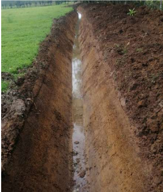
Figura 3. Drenaje primario para mejorar la salida del agua en plantaciones en zonas bajas muy húmedas, zona norte de Costa Rica.
